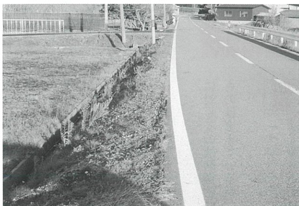
路肩盛土がくずれた町道
