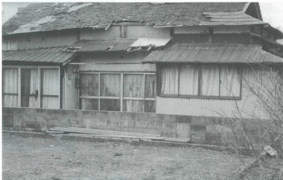
老朽化が著しい空き家
