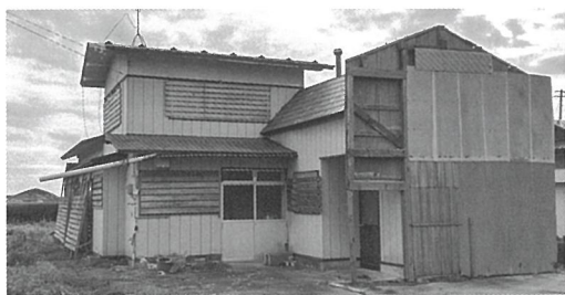
年々老朽化が進む空き家
