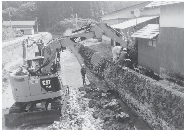
記録的大雨による被災地（井内町内）
