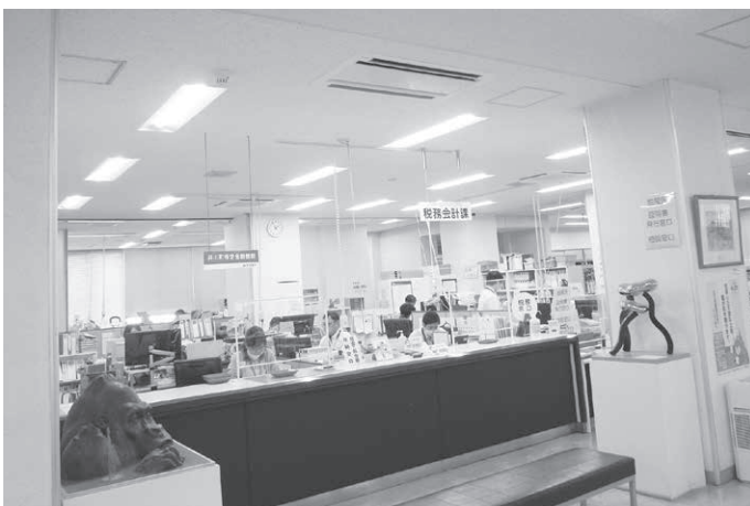
新しいエアコンを設置した役場庁舎
