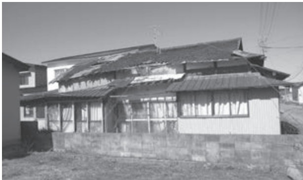
近隣への被害が懸念される空き家
