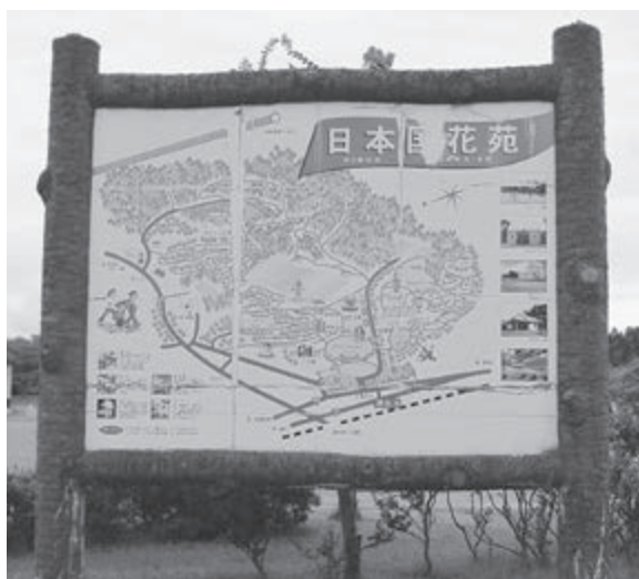
劣化した総合案内板
