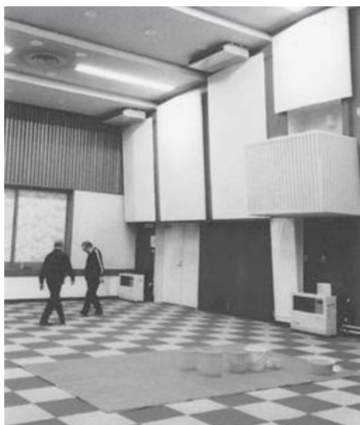
雨漏時の公民館ホール
