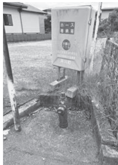
天神地区 消火栓
